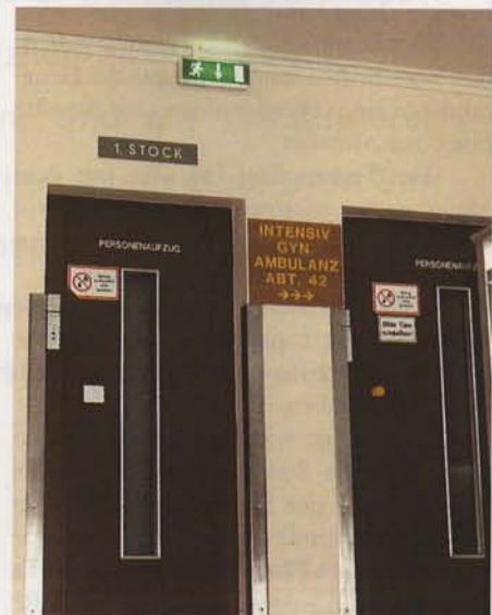
Kürzlich neu an der Decke eines Spitals montierte Fluchtwegzeichen, die zuerst vom Rauch verdeckt werden und zudem ausgerechnet über dem nicht zu benützenden Lift stehen (Bild: B. Hersche)
